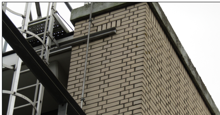
Figuur: ook op deze foto zijn open stootvoegen zichtbaar, welke geschikte invliegopeningen zijn voor vleermuizen.
