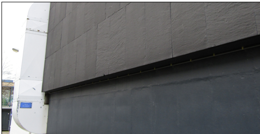
Figuur: achter de beplating is een open ruimte aanwezig, welke via de onderzijde toegankelijk is voor vleermuizen.
