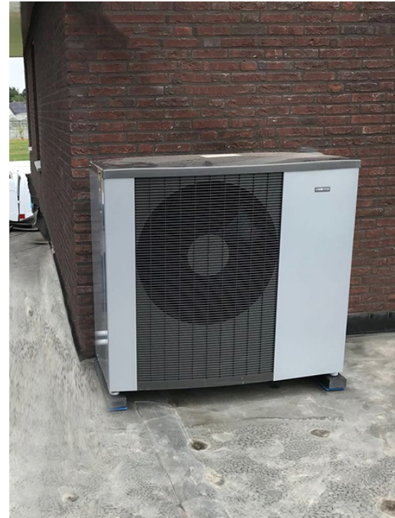
Buitenunit op plat dak
